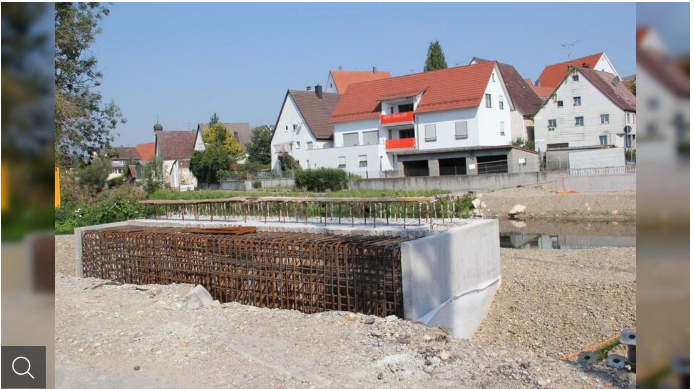
In die Widerlager rechts und links der Donau wird später die fertige Stahlbrücke eingefädelt. (Foto: Marion Buck)
