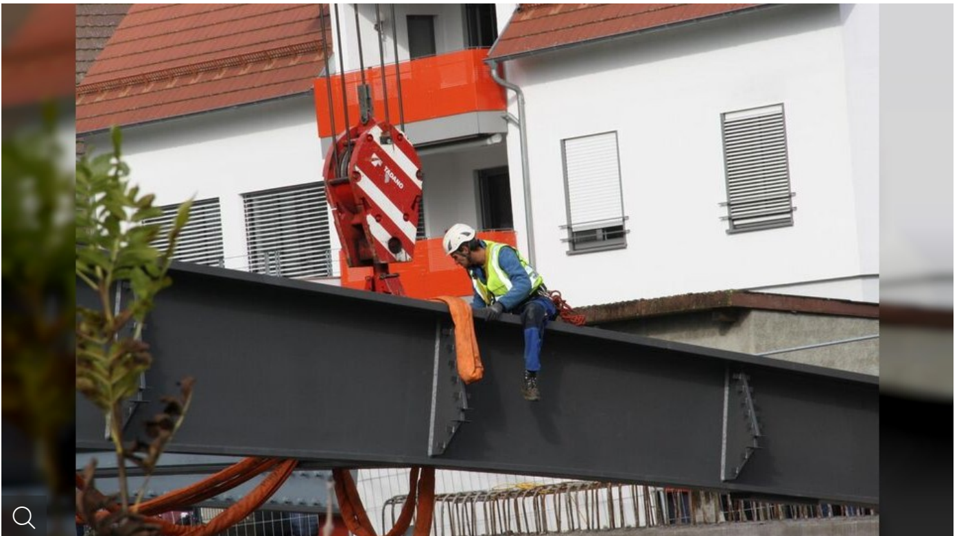
Schwindelfrei musste der Mitarbeiter sein, der den Haken des zweiten Krans in luftiger Höhe befestigte. (Foto: Marion Buck)
